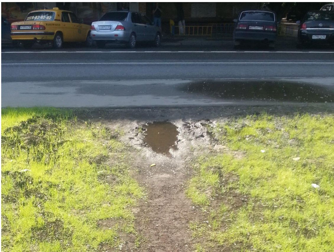
Рисунок 6. Стоки для воды отсутствуют. Вода скапливается на пешеходных дорожках
